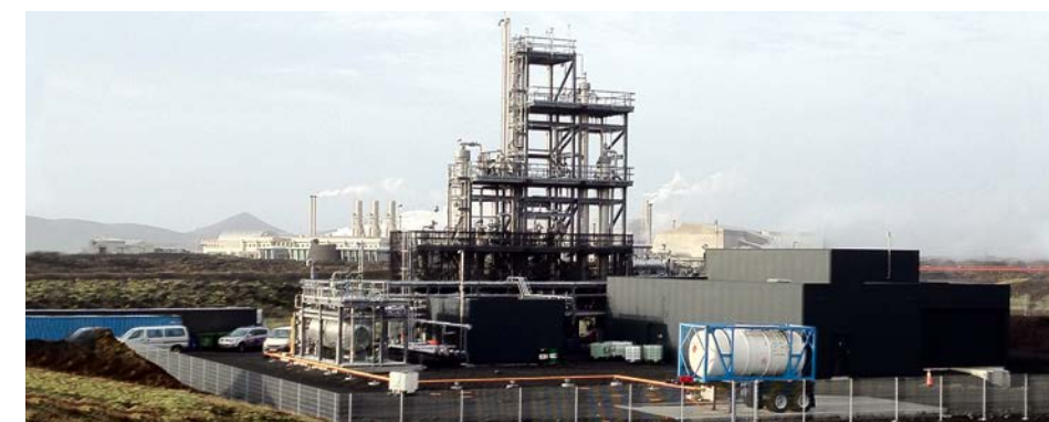
Der Konsortialpartner Carbon Recycling International betreibt auf Island seit über zehn Jahren erfolgreich Methanol-Anlagen, die dort mit Geothermie-Kraftwerken kombiniert werden. Foto: CRI
