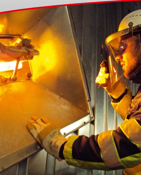
Abb. links: Kontrolle des Feuerraums
